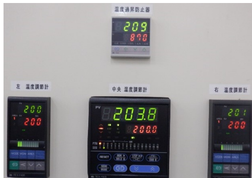
設定温度 200℃稼働 表示温度
